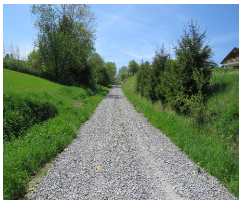
Remont drogi dz. nr ew. 810 w miejscowości Średnia Wieś w km od 0+217 do km 0+720 (503 mb) – 76 850,71 zł (z czego 50 000,00 zł dofinansowane z budżetu PGL LP Nadleśnictwo Lesko).
