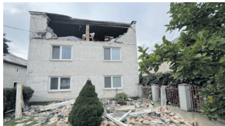
▲ Uszkodzenia budynków w Ďapalovcach – 10.10.2023
