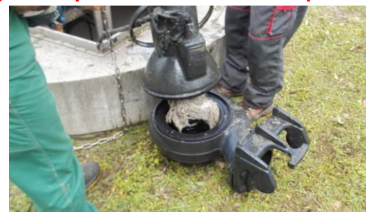
Zdj. 3. Pompa ściekowa zablokowana przez materiały włókniste
