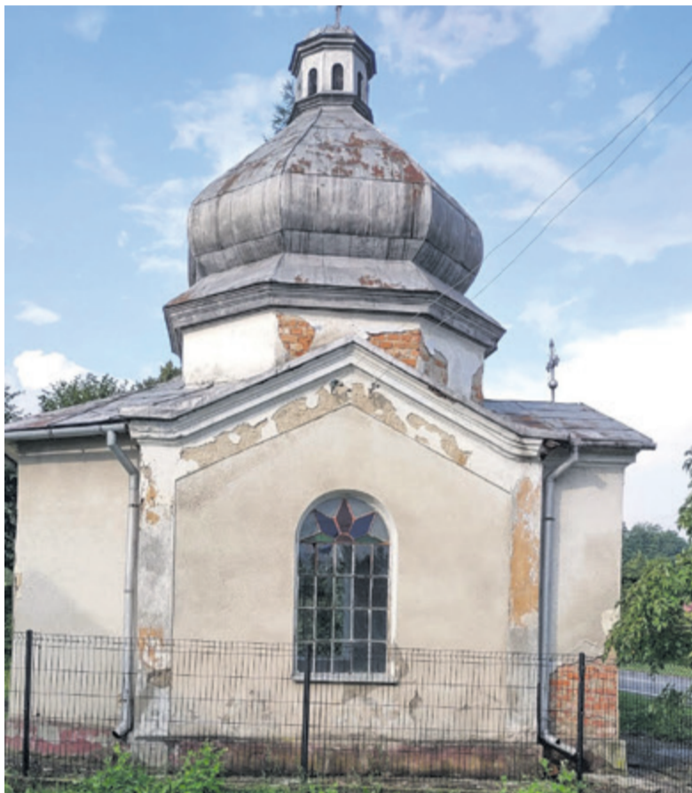
▲ Ze względu na brak właściciela parafianie nie mogli się podjąć remontu kaplicy, przeprowadzono tylko drobne prace mające charakter kosmetyczny
