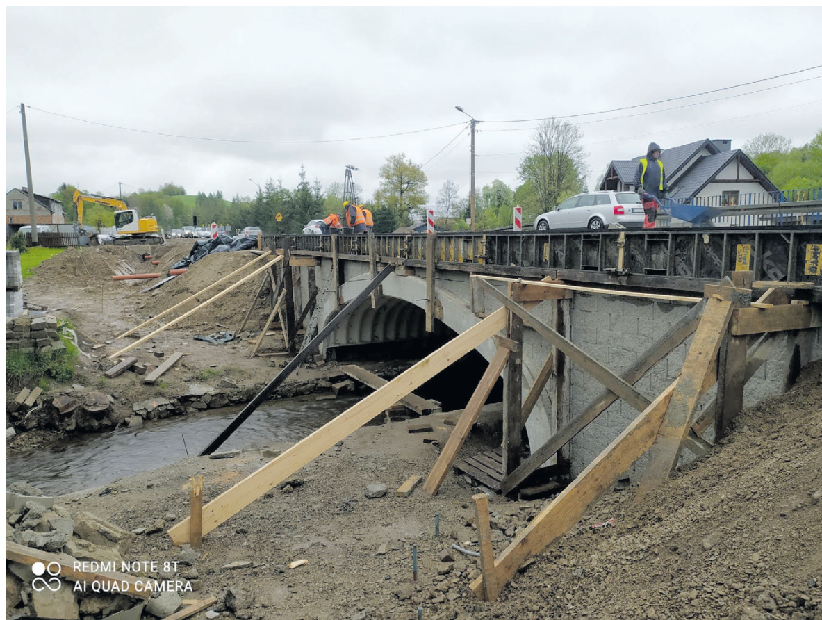
▲ Kolejnym remontem, który napotkamy jadąc DK nr 84, jest remont mostu na rzece Olszanka w miejscowości Stefkowa, w gminie Olszanica
