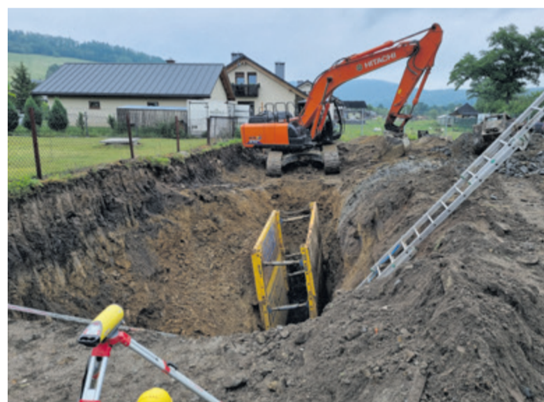
▲ W tej chwili największą inwestycją realizowaną przez Gminę jest budowa kanalizacji sanitarnej w Hoczwi
