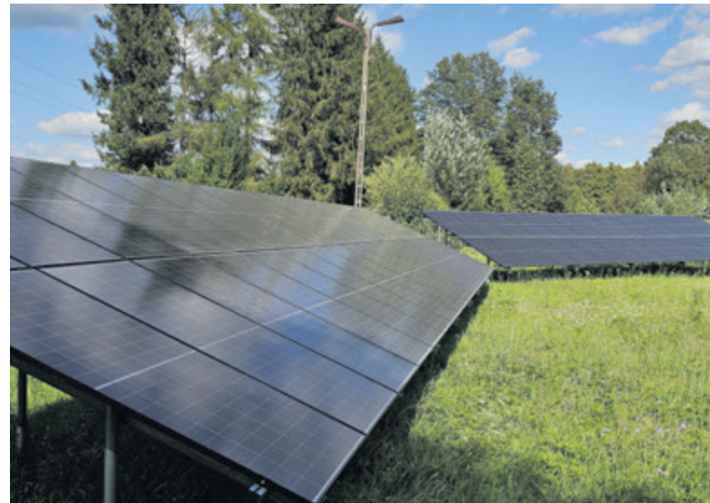
▲ Panele fotowoltaiczne zamontowane przy SUW-ach na ulicy Wolańskiej
