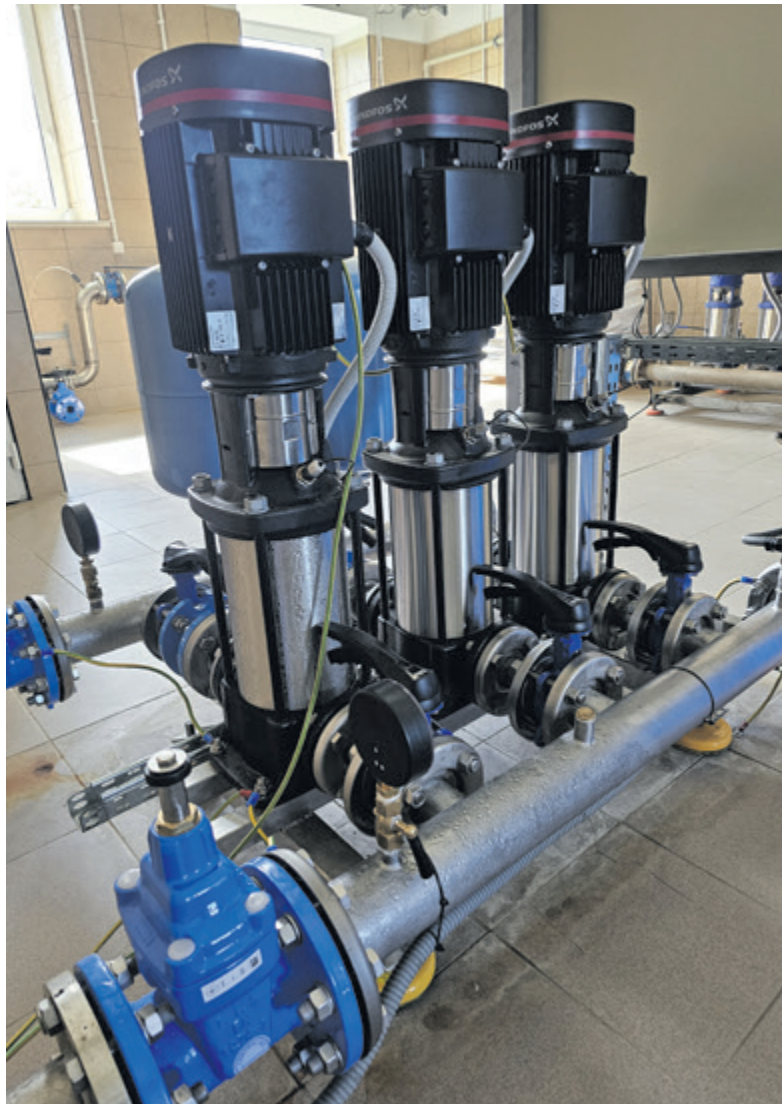
▲ Nowe pompy i armatura montowane są zarówno w studniach głębinowych, zbiornikach wody, jak i na SUW-ach
